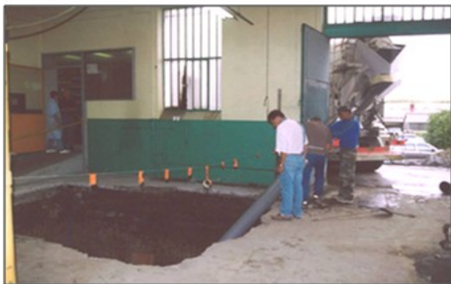
Juin 2003 : effondrement dans la concession du Treuil
